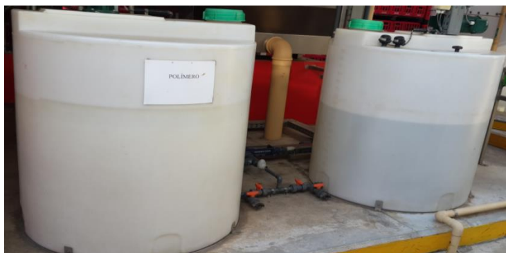
Figura 11: Estação de dosagem de polímeros
