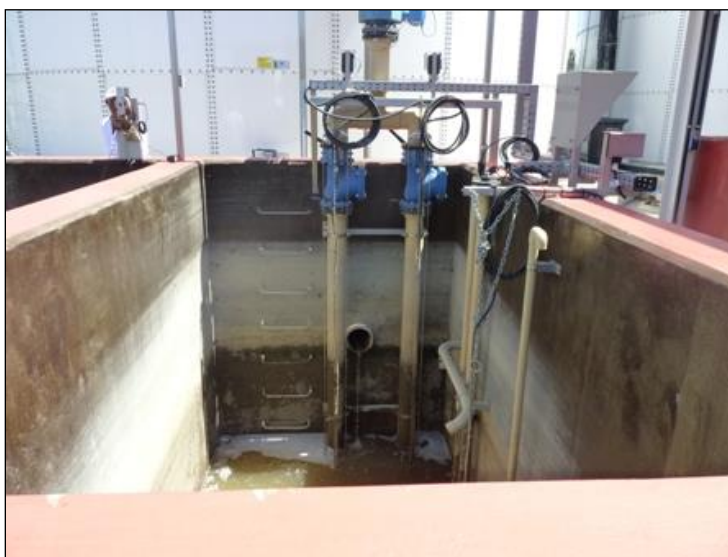
Figura 9: Poço de pré-neutralização
