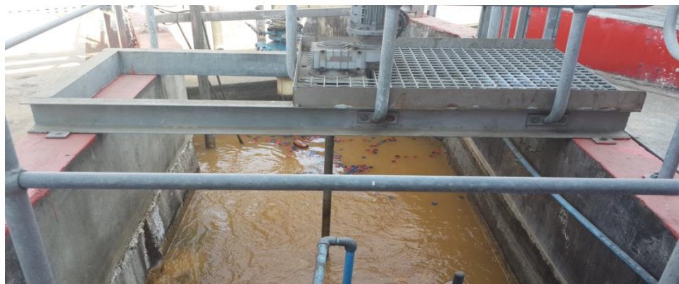
Figura 6: Efluente bruto descarregado no 1º poço de entrada
