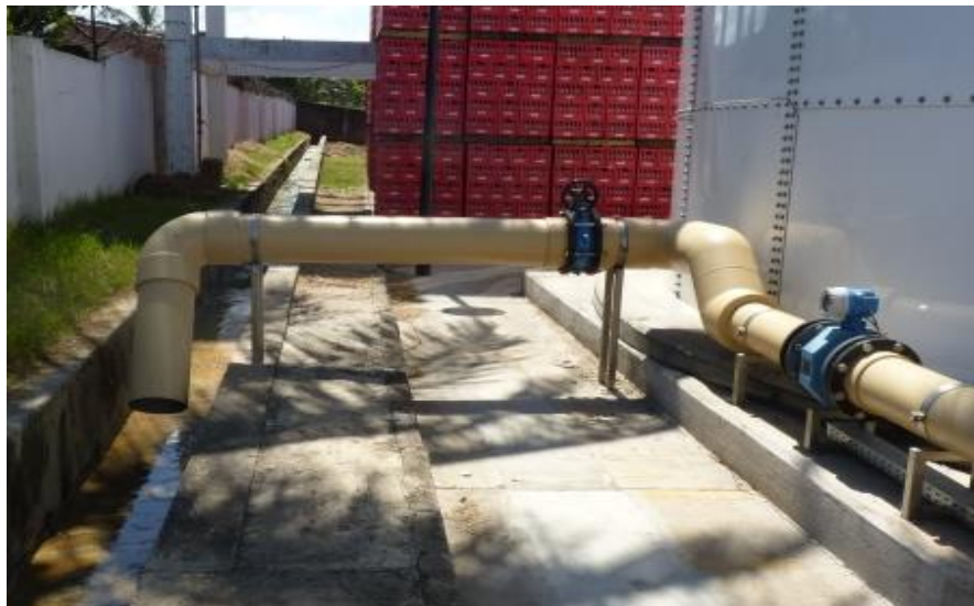
Figura 16: Canal de saída do efluente final da ETAR
