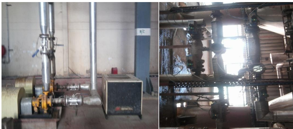
Fig.11: Exemplos de instrumentos de medição usados na fábrica Maêva. Válvula (à esquerda) e medidores de pressão e fluxo (à direita).
