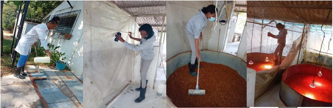
Figura IV.A- Desinfecção dos cercos; B-desinfecção das cortinas; C- montagem do cerco e colocação da cama; D-Colocação das lâmpadas infravermelhas.
