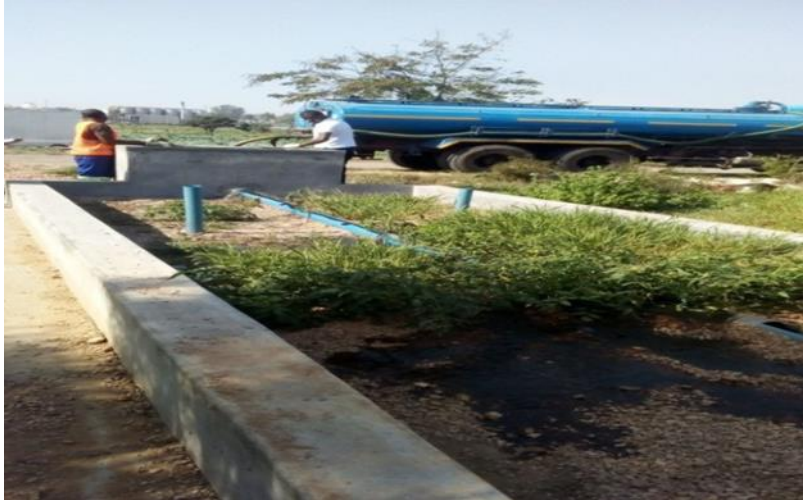
Figura 1: Wetlands construído de fluxo vertical
