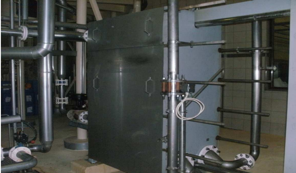
Permutador de calor – tem a função de baixar a temperatura do mosto
