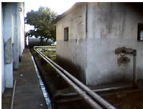
Figura A3-1. Tanque de armazenameto dos CFM
