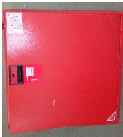
Figura 15 - Boca de Incêndio [15]
