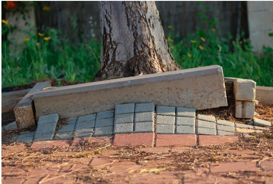
Figura 4: Danificação do passeio devido a problemas com as raízes da árvore
