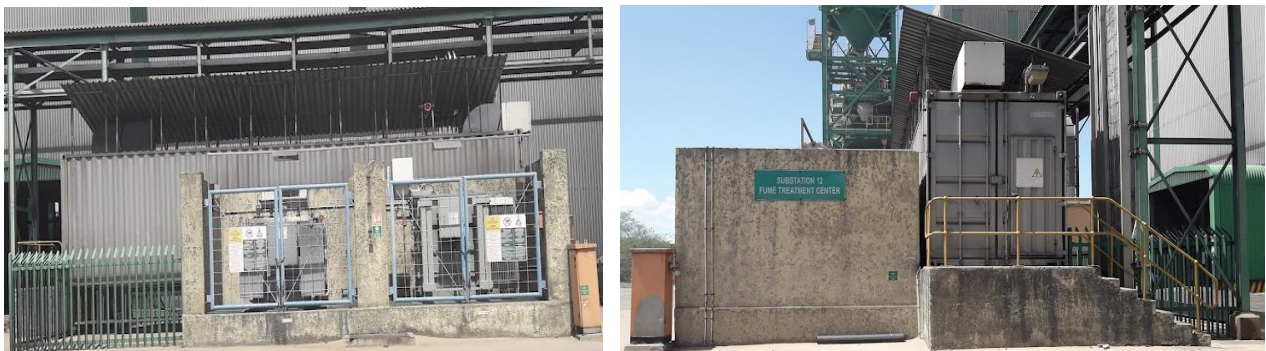
Figura 1: Instalações exteriores do PT 12
