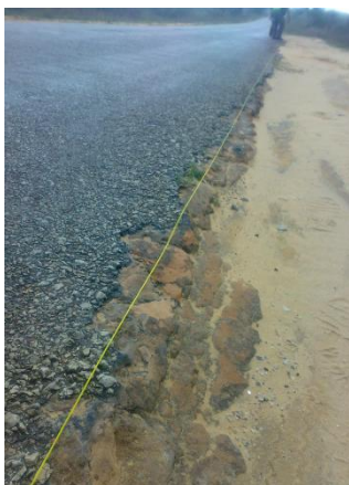
Figura 10. Rachadura de borda
