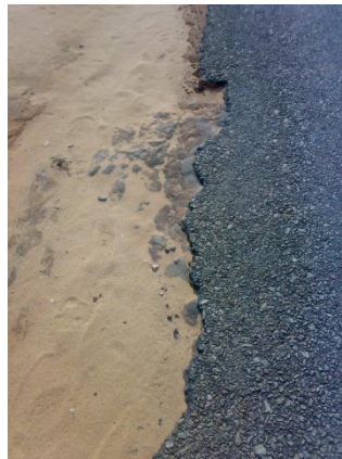
Figura 8. Rachadura de borda
