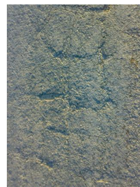
Fig. 24. Rachadura em bloco
