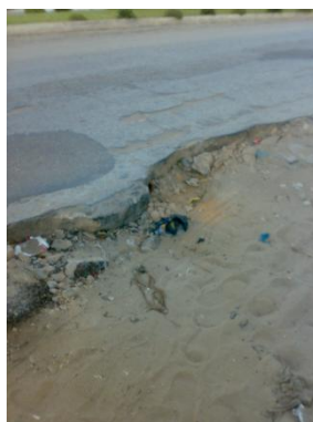
Fig. 23. Rachadura de borda
