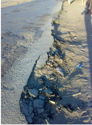
Fig. 16. Rachadura de borda
