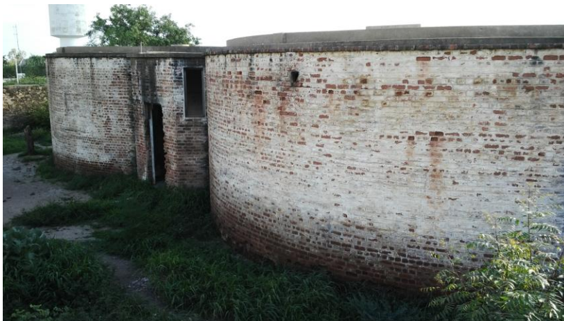
Figura 2. Degradação da parede do forte Dom Luiz, por factores naturais, vegetação e chuva. Foto de: Fernando Chissale.
